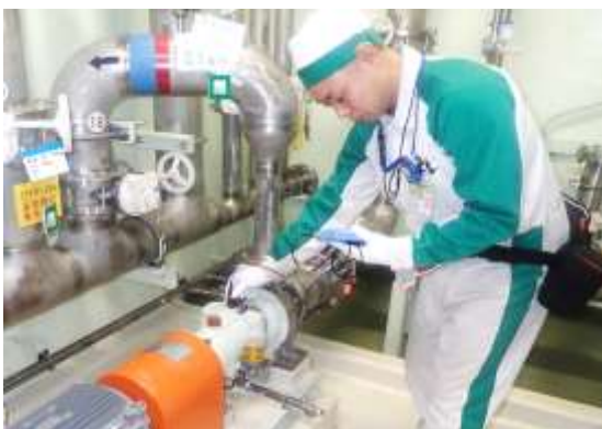
③月例点検(冷却水ポンプ)
