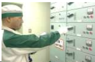
①日常点検(機器の電流値確認)
