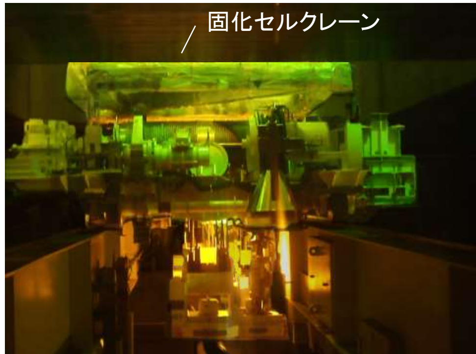
固化セルクレーン
