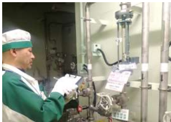
②日常点検(エア流量の確認)
