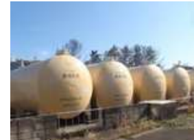
液体処理場 (廃液タンク)
