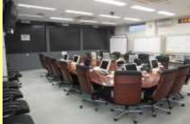
緊急時対策所 (T.P.約6m)
